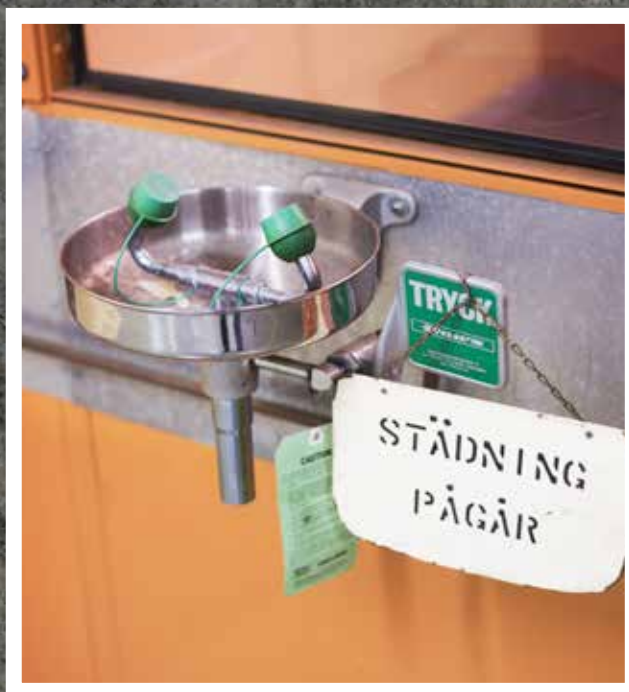
Vid väggen till svetsverkstaden sitter en station för ögondusch monterad.
